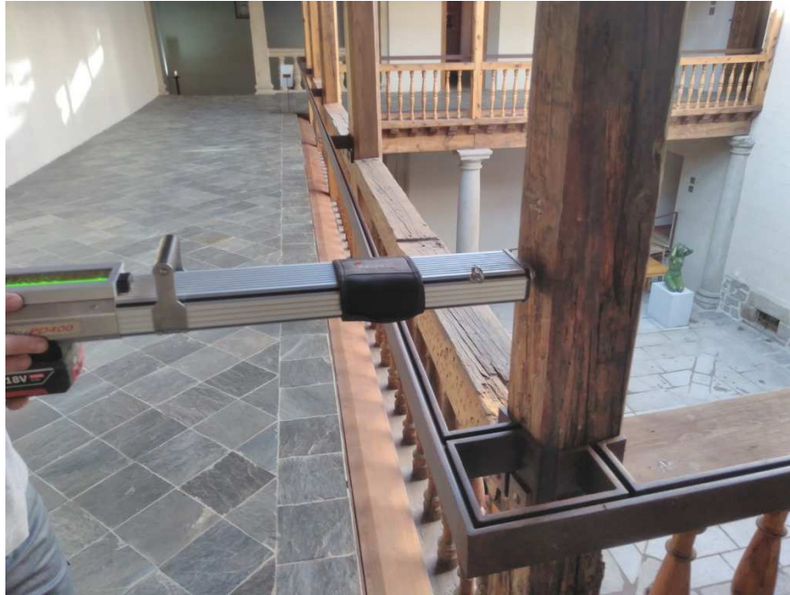
Imagen 3. Ejemplo de aplicación de la técnica de resistografía a un pilar de madera de un edificio histórico.
